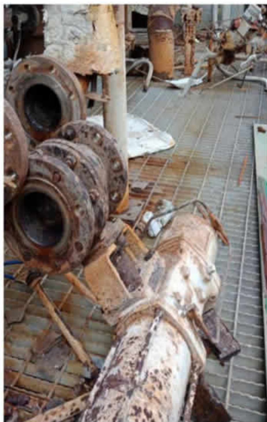
500吨还原装置区挥发瓶总管
