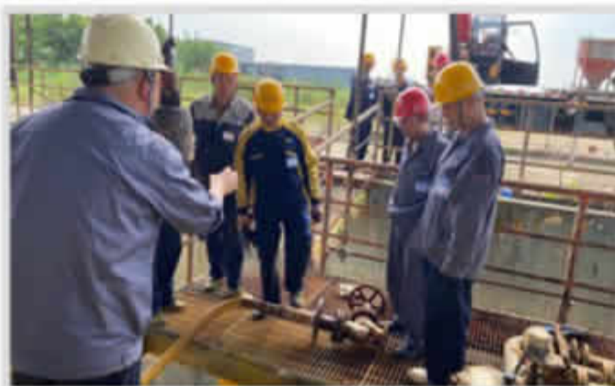
勘察现场阀门
