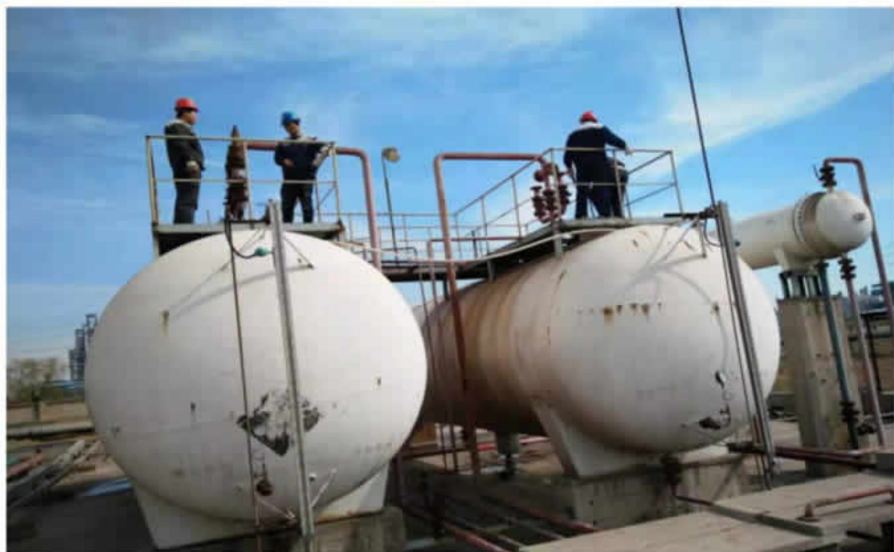
丙烯气体回收槽
